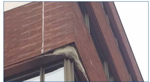
Разрушенная перемычка над оконным проемом
