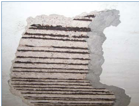
Корродированный металл становится причиной выкрашивания бетона
