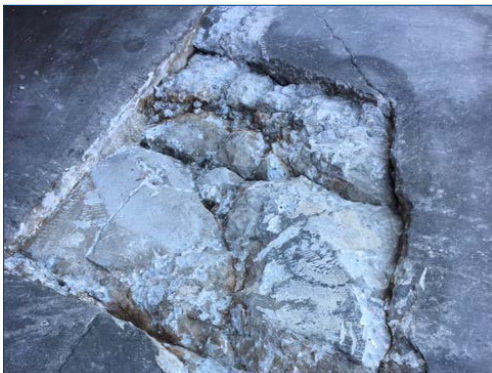
Интенсивное уличное движение приводит к разрушению дорожного покрытия
