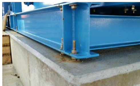
Формирование подливки: до ремонта
