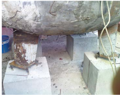
Поврежденные опоры технологической емкости
