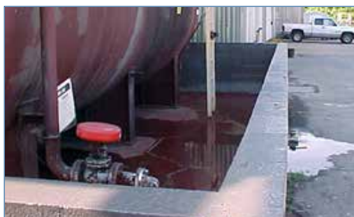
Повреждение бетона из-за непригодности старой ремонтной системы
