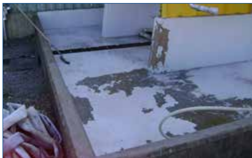
Поддон для резервуара с 98%-ной серной кислотой нуждается в ремонте
