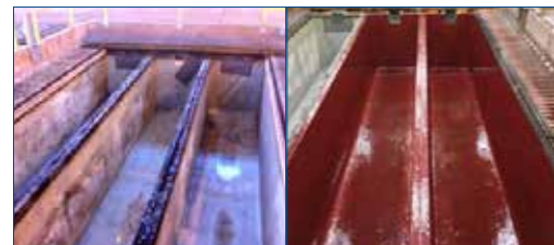
Опорная рама на медном заводе защищена от воздействия электролита \text{CuSO}_4
