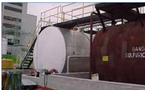
Зона обвалования для серной кислоты (справа) и щелочи (слева)
